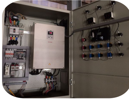
Dự án lắp đặt cho Máy Luyện Kim
