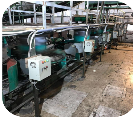
Nâng cấp hệ thống Vò Chè cho nhà máy chè Hà Tĩnh
