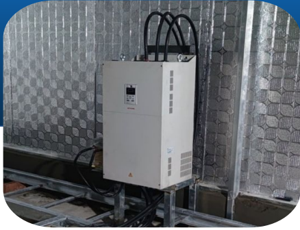
Biến tần 160kW cho Máy Luyện Kín
