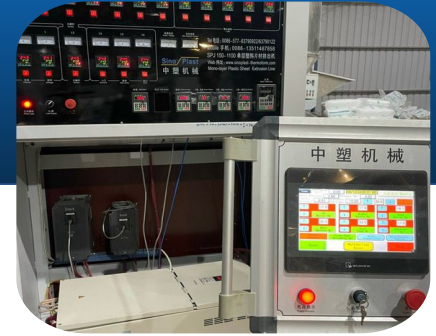
Biến tần 185kW cho Máy Đùn Nhựa
