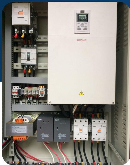
Biến Tần GK620 90kW cho Cầu Tháp
